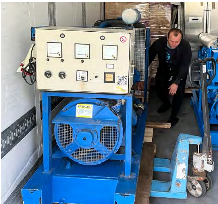
Een grote generator
